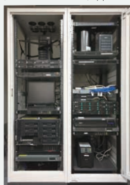
サーバコンピュータ群
