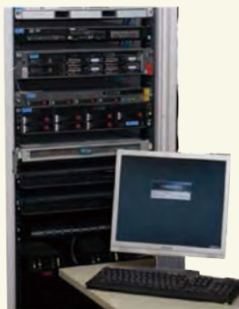
サーバコンピュータ群
