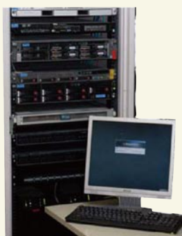
サーバコンピュータ群
